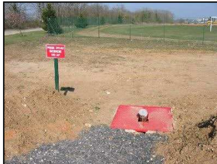
Les puits d'aspiration.
