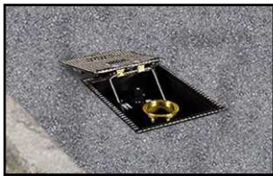
Les bouches d'incendie (ou BI).
