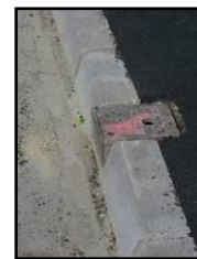
Les bouches d'arrosage ou de lavage.
